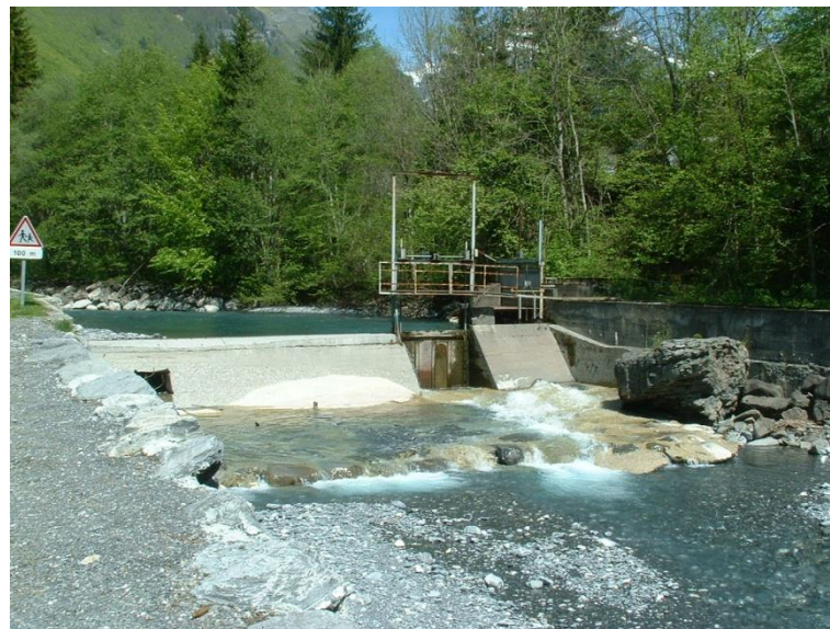
Photo 19 : Prise d'eau de microcentrale hydroélectrique sur le Giffre (source : SM3A)
